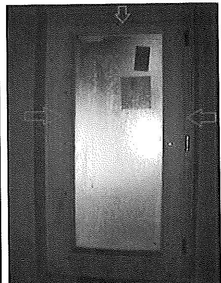
Photo N° 4351 Flux d'air au travers de l'ouvrant fenêtre dans la salle de bains
