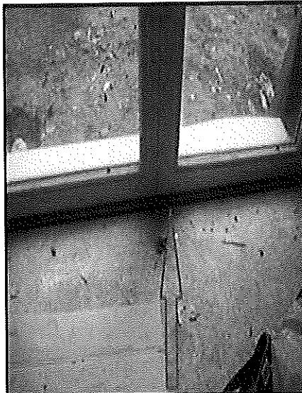
Photo N° 4358 Flux d'air au niveau de la liaison seuil/sol de la porte fenêtre du séjour
