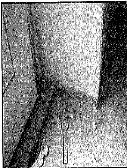
Photo N° 4361 Flux d'air au niveau des liaisons périphériques (parois, plancher) dans le séjour
