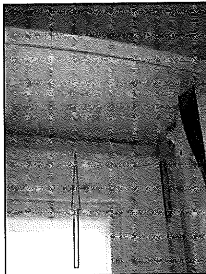
Photo N° 4350 Flux d'air au travers de l'ouvrant fenêtre dans la chambre
